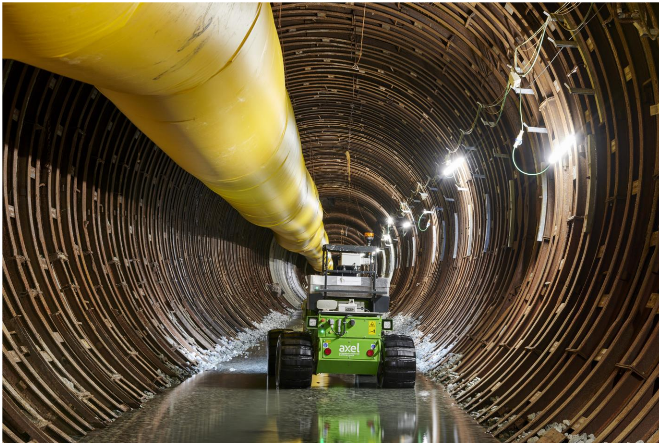
Ing. L. Brino- AXEL (Autonomous Exploration Electrified Vehicle), l' <<esploratore>> telecomandato del cunicolo geognostico della Maddalena
